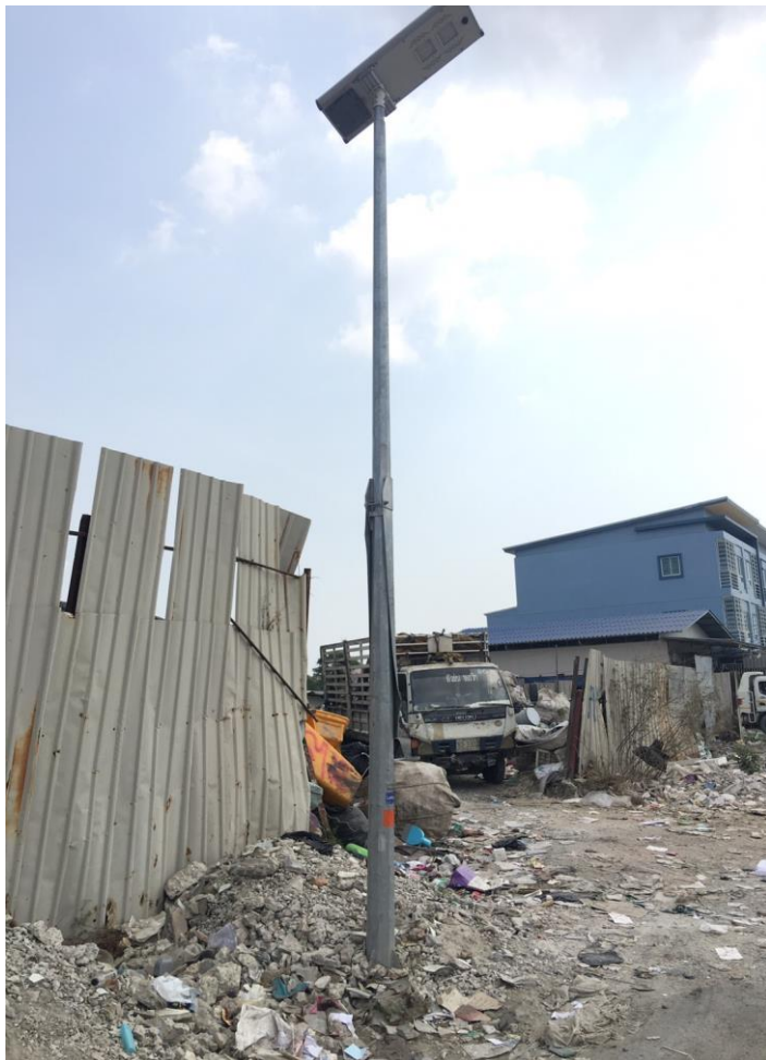
เสาไฟโดนรถเฉี่ยวชนได้รับความเสียหาย
